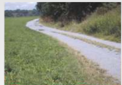
Typische Verschleißerscheinungen an einem gut frequentierten Schotterweg
